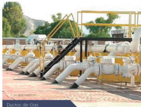
Ductos de Gas
